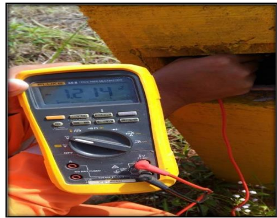
Gambar 4.10 Nilai Tegangan pada Test Box
