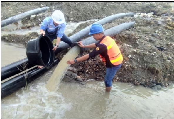
Gambar 4.2 Pengukuran Debit Outlet Pompa
